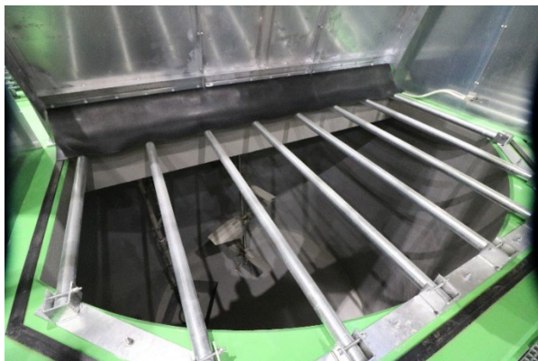
前処理棟内 原料混合ピット
