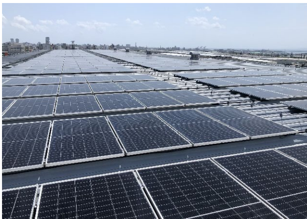
メイクマン物流センター（AC100kW）
