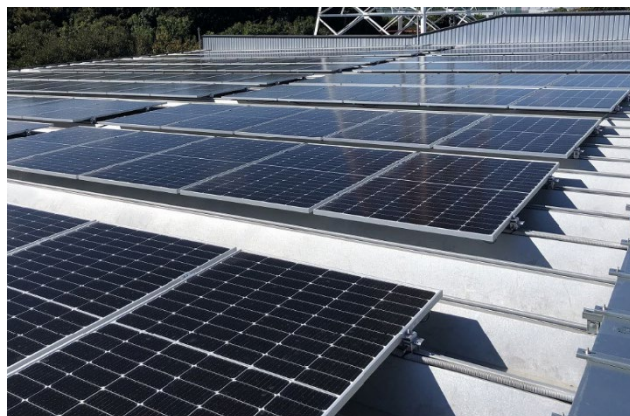
自社所有型屋根置き太陽光発電設備（AC50kW）
