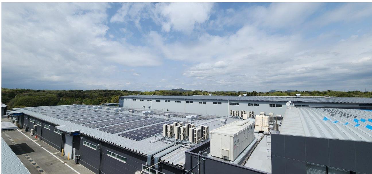
バッテリーサポートセンターに太陽光発電設備を設置
