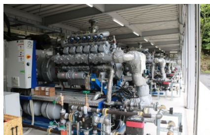
熱電併給装置 900kW (150kW×6台連結)
